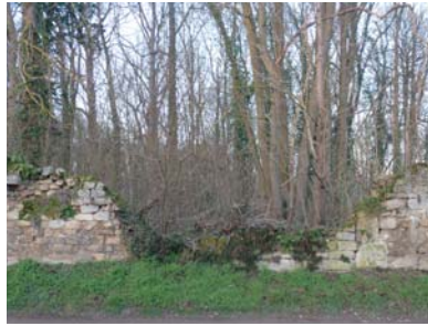
Un mur laissé en l'état après effondrement
