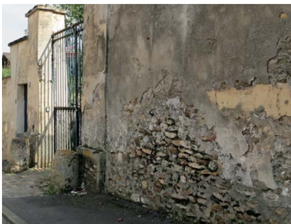
Le soubassement est plus altéré que le reste du mur. Le phénomène est ici accentué parce qu'il s'agit d'un enduit ciment
