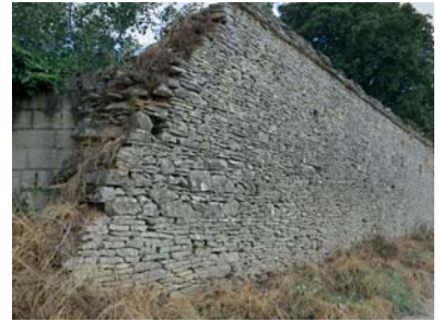
Sans protection le mur continue de se détériorer
