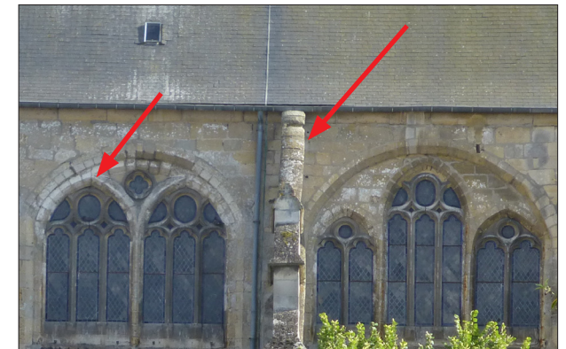
Altération importante de la pierre - Absence d'une protection en plomb Fissure au droit de la baie vitrée
