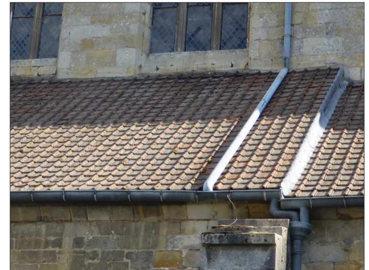
Couverture en tuiles mécaniques - Descentes EP positionnées de façon inadaptée
