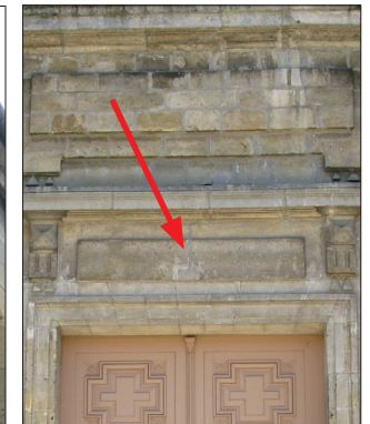
Réboilage des fissures - Absence de protection sur les parties saillantes
