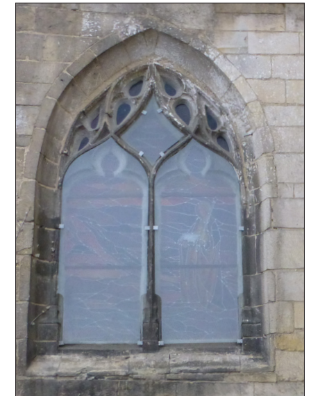
Découpage de la protection ne suivant pas exactement les lancettes - Fixation inadaptée - Réseau non protégé
