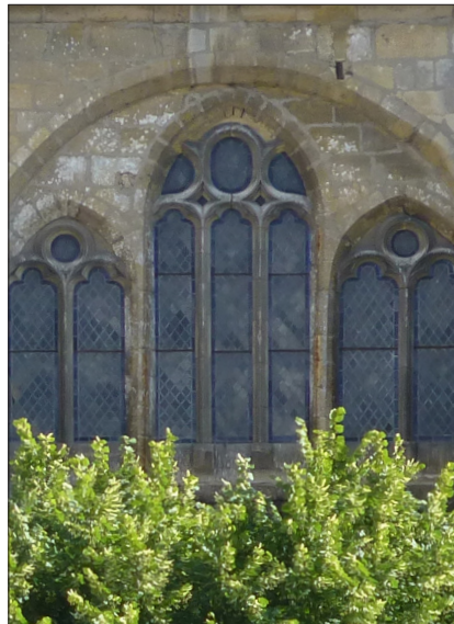
Panneaux déformés - Barlotières oxydées
