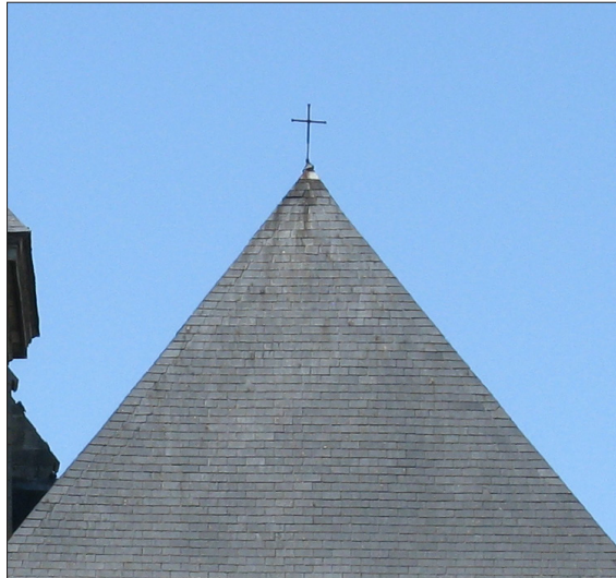
Faîtage cassé - Ardoises glissées ponctuellement
