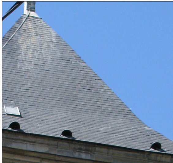
Ardoises glissées et levées au droit des arêtières
