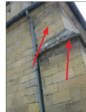
Ragréages - Altération avancée de la pierre et perte de matière
