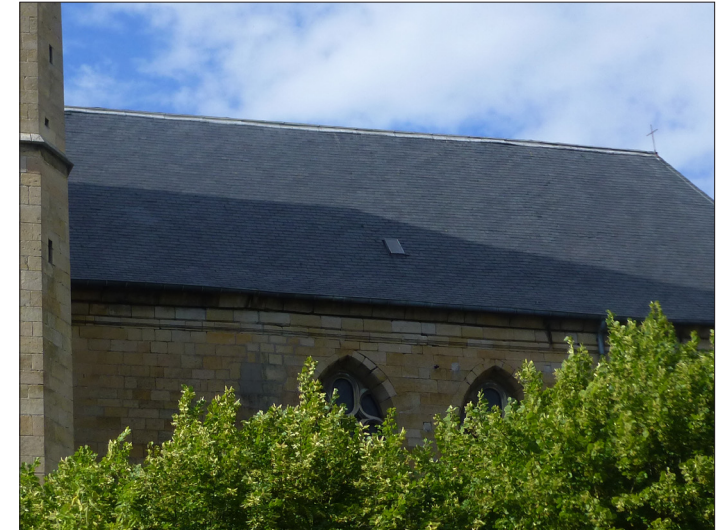
Faîtage déformé - Ardoises glissées ponctuellement
